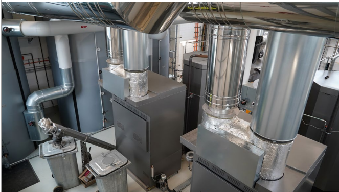
Abgasreinigung der Heizung auf Konrad
