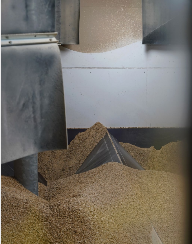
Pelletheizung auf der Schachtanlage Konrad
