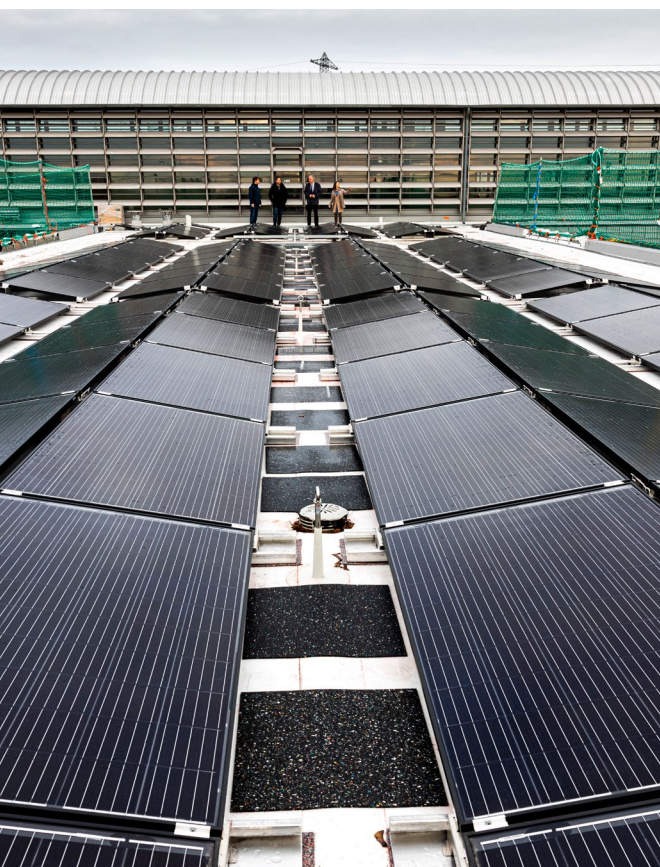
Photovoltaikanlage auf dem Dach am Standort Peine
