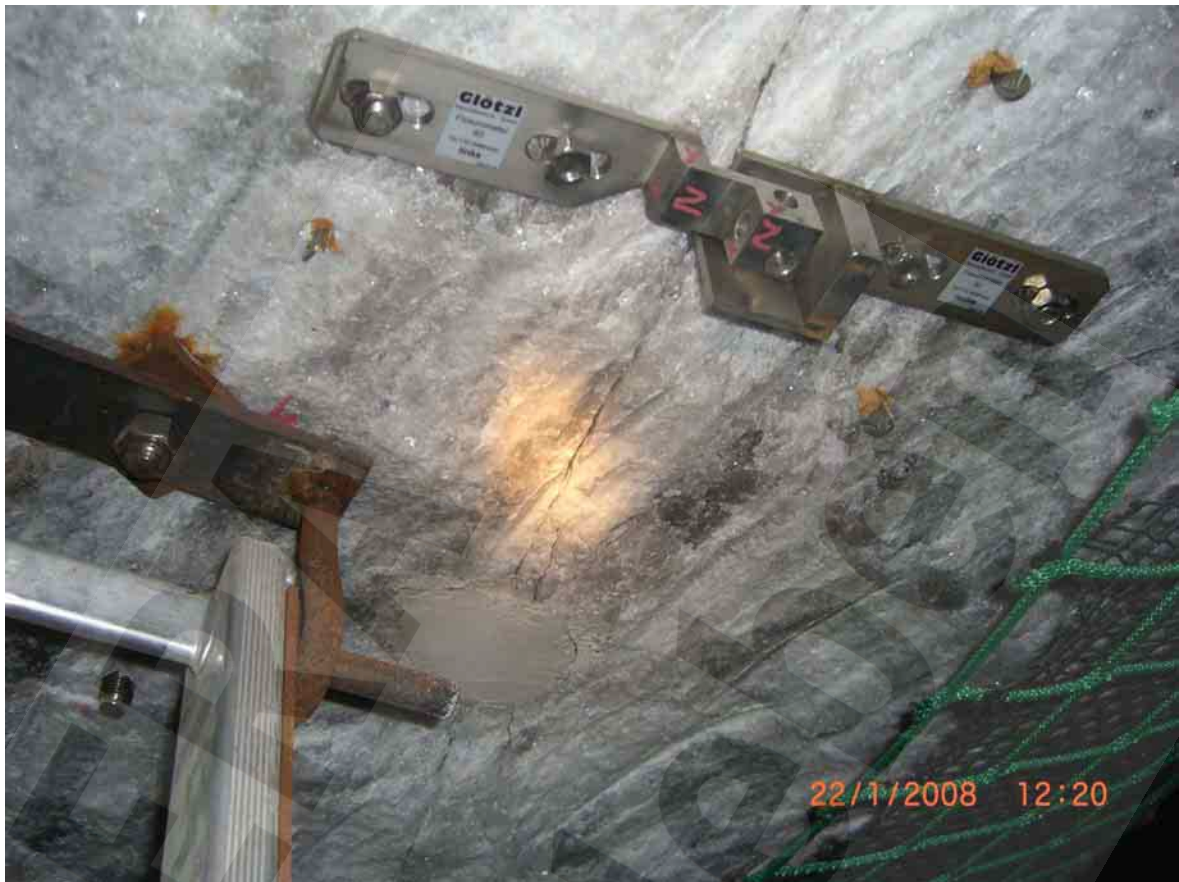
Abbildung 1: Firste des Durchhiebs 17YEA63/R007 (Durchhieb 4, 4. Sohle) zum Abbau 16YEA61/R003 (Abbau 2, 4a Sohle; rechter Bildrand). Rissfläche an der Firste mit Fissurometer CG188F (Stand 22.01.08)
