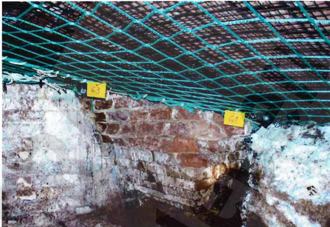
Bild 6: Gewölbe bei -194 mNN GS 5, weggebrochener Mauerfuß.
