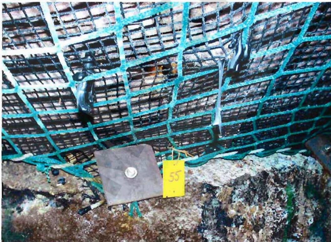
Bild 7: Austretender Asphalt bei -194 mNN am GS 8 und GS 9
