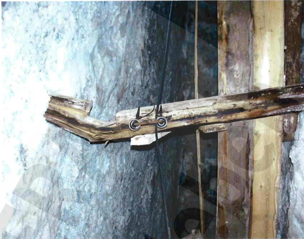
Bild 9: Lager H – gebrochener horizontal querschlägig eingebauter Bühnenträger bei -188 mNN im Januar 2002. Während der Sicherungsarbeiten Ende 2002 wurde der Träger erneuert.
