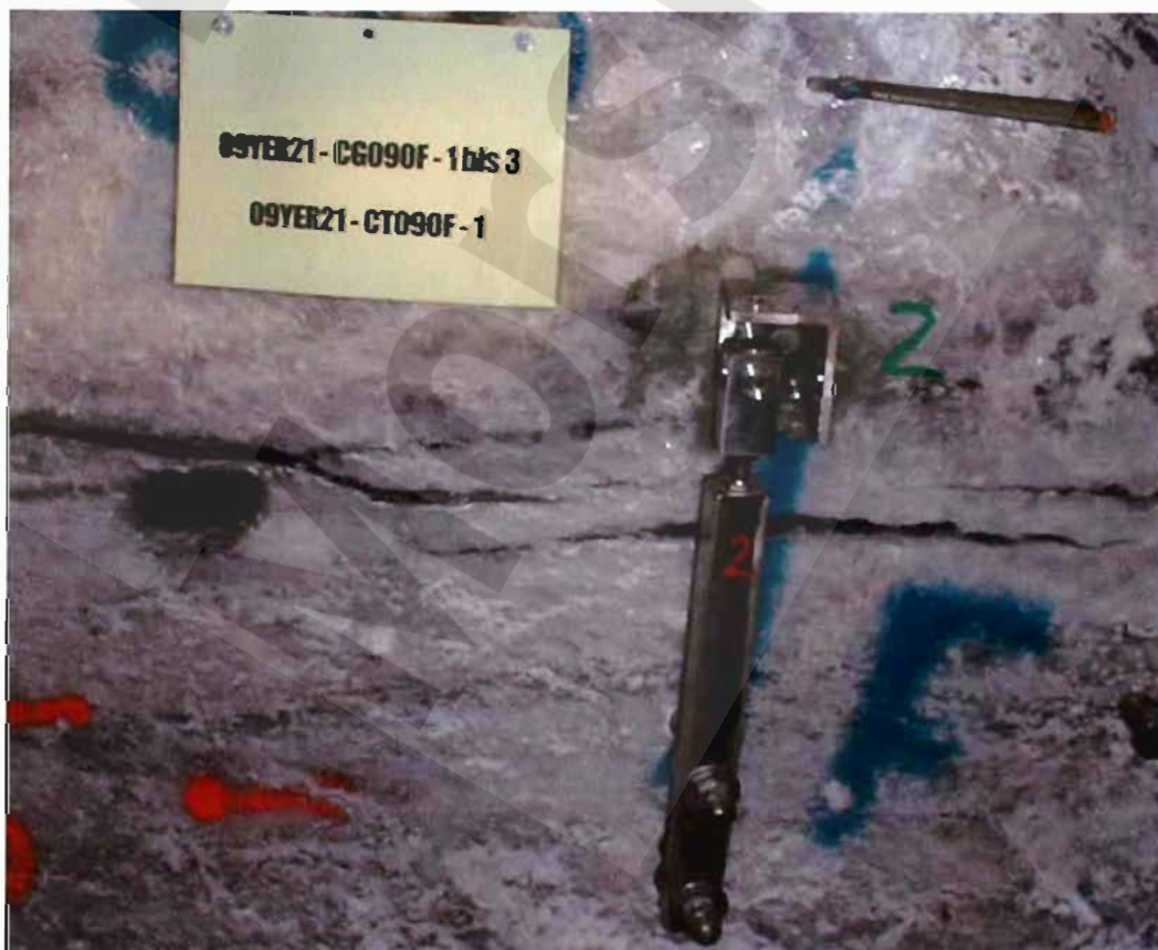
Bild 2: Fissurometer am westl. Stoß des Abbaus 2n der -253 mNN Sohle
