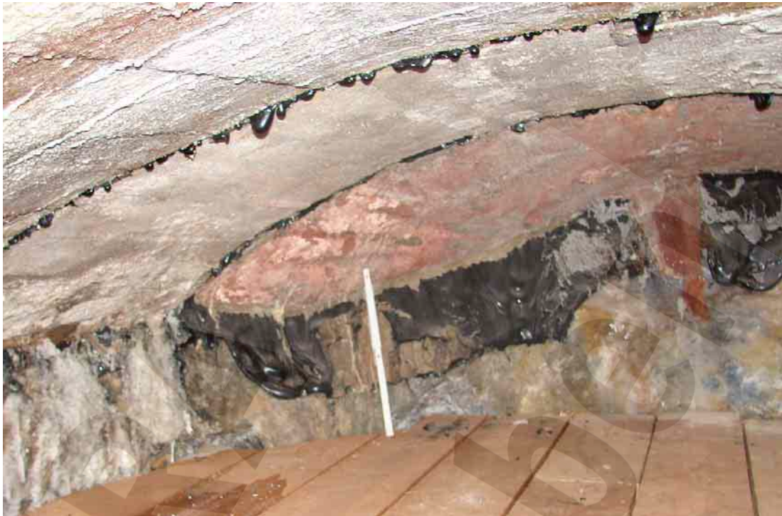
Abbildung 8: Ausgetretener Asphalt im Gewölbesegment GS 1 bei -202 mNN.
