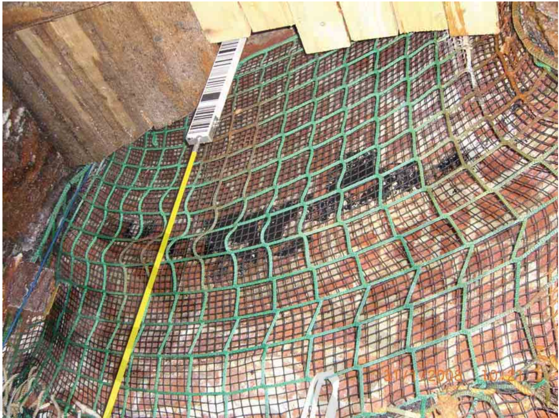
Abbildung 4: 2007 beraubter Bereich im Gewölbesegment GS 11 bei -190 mNN.
