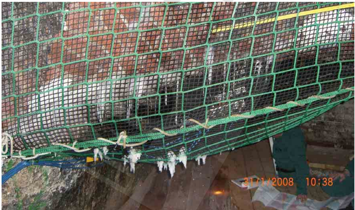
Abbildung 5: Gewölbesegment GS 10, Bühne 3, Feuchtstellen am östlichen Stoß.
