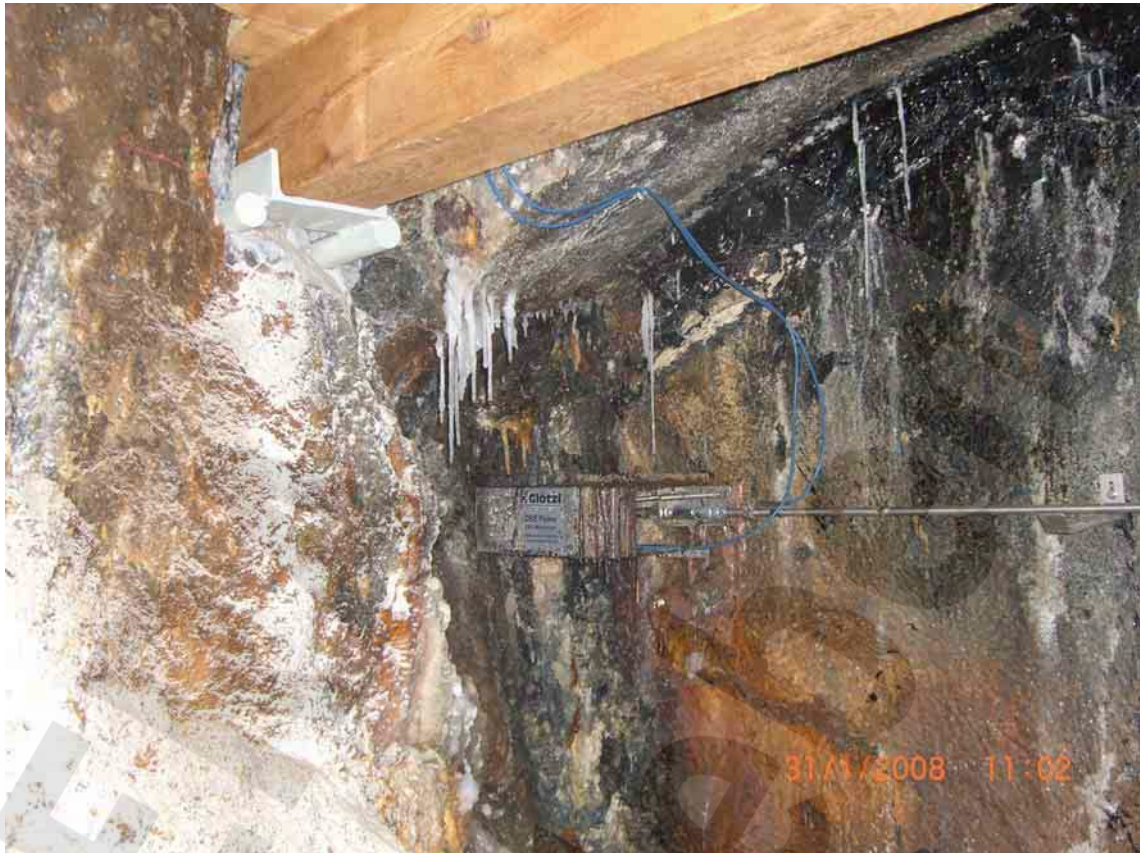
Abbildung 7: Gewölbesegment GS 4, Feuchtstellen am östlichen Stoß, Extensometerkopf CG011E.
