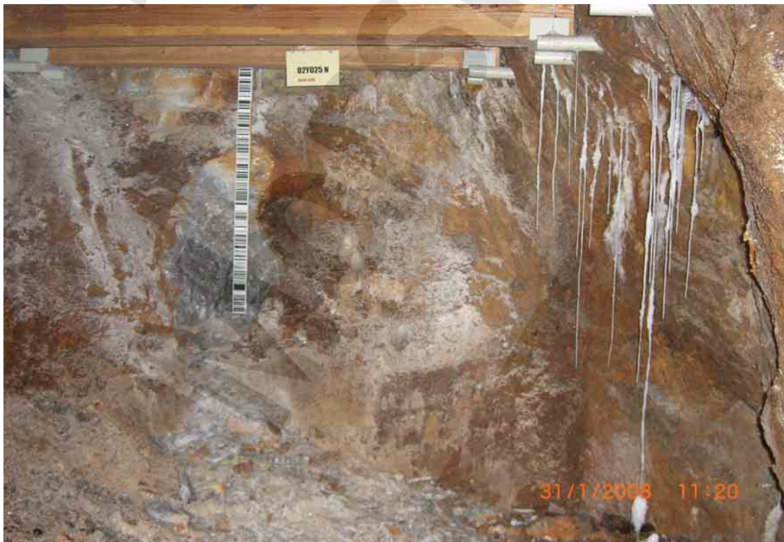
Abbildung 9: Abbausohle, Niveau -204 mNN, Tropfstellen am westlichen Stoß.
