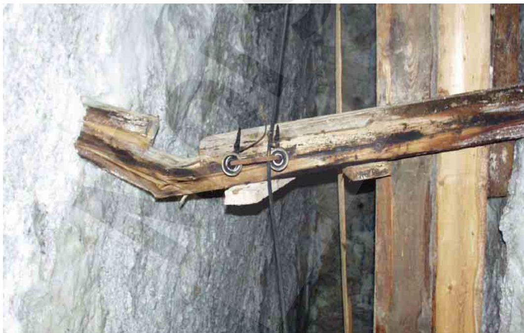
Abbildung 10: 02YER71/R001 (Lager H) – gebrochener horizontal querschlägig eingebauter Bühnenträger bei -188 mNN in 01/02.
