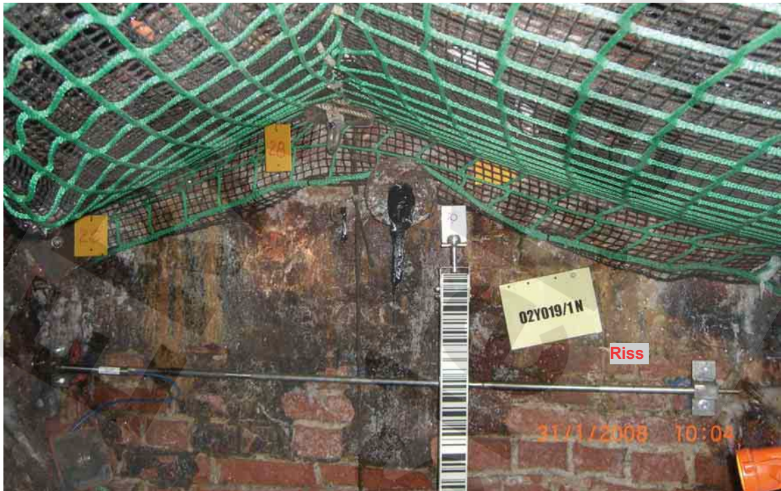
Abbildung 3: 2007 beraubter Bereich im Gewölbesegment GS 11 bei -188 mNN.
