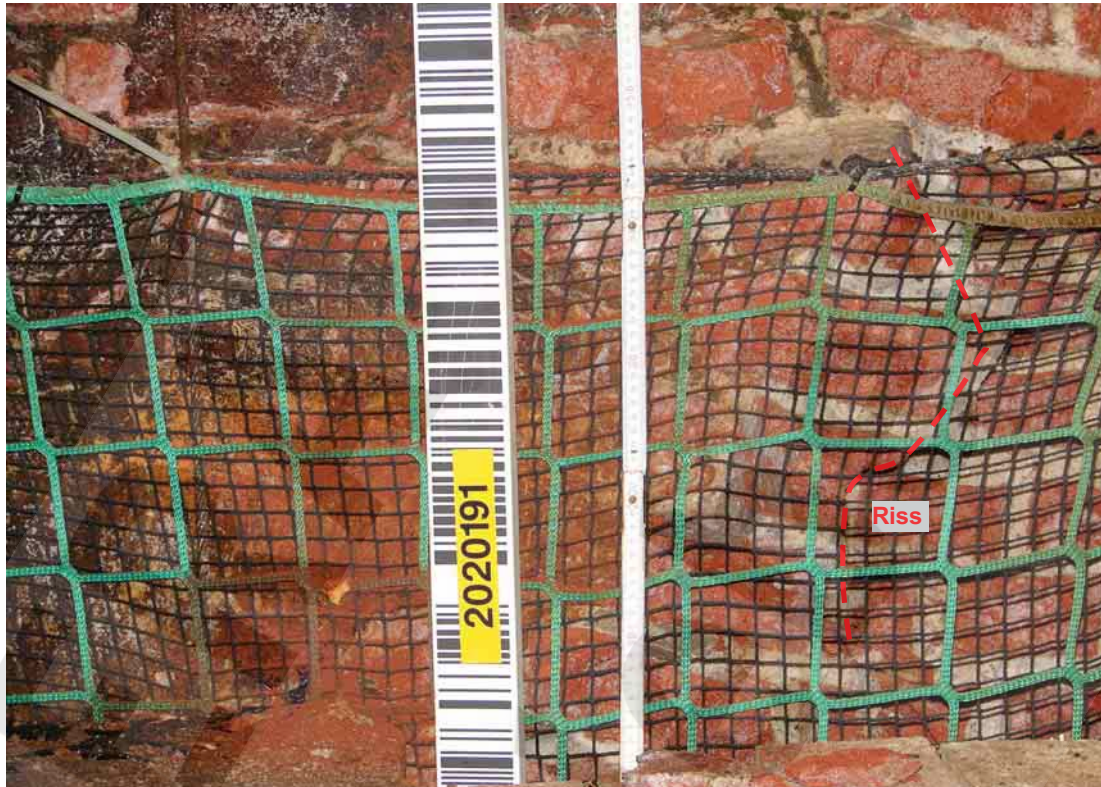
Abbildung 4: Gewölbesegment GS 11, Abplatzung, Bühne 0, bei -188 mNN
