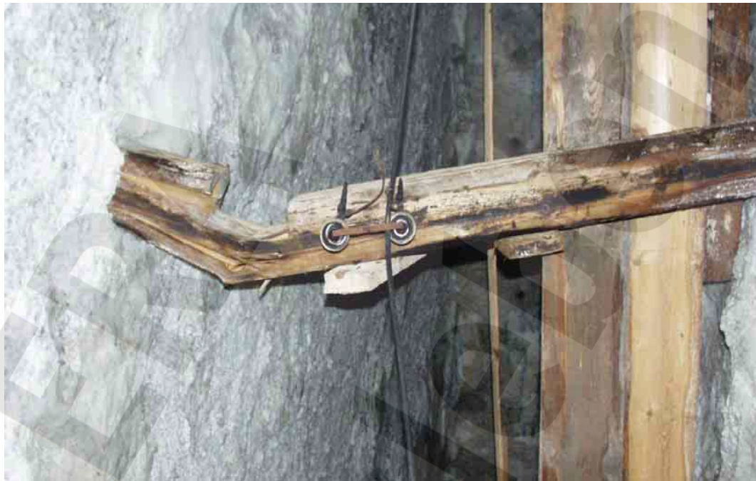
Abbildung 11: 02YER71/R001 (Lager H) – gebrochener horizontal querschlägig eingebauter Bühnenträger bei -188 mNN in 01/02
