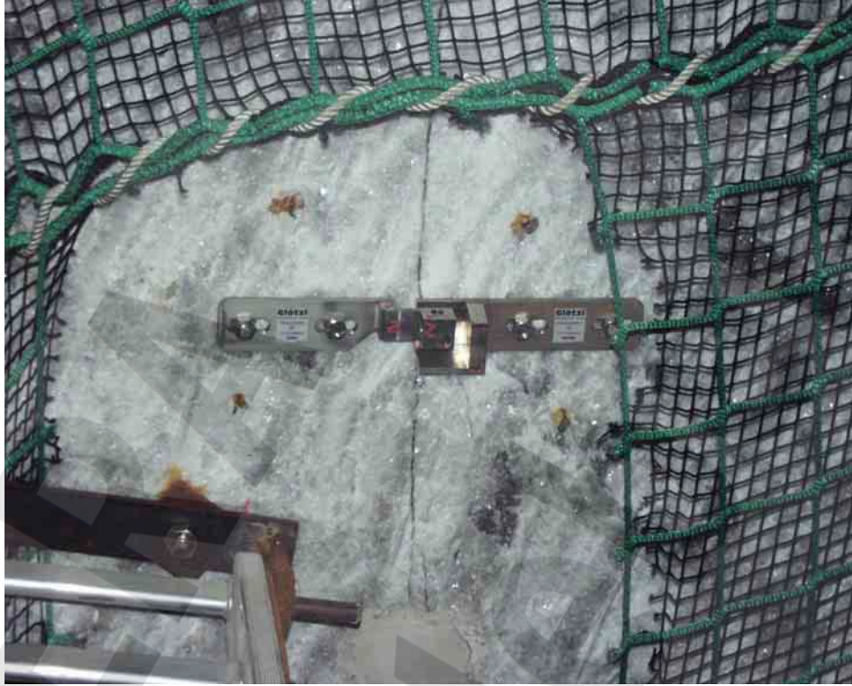
Abbildung 1: Firste des Durchhiebs 17YEA63/R007 (Durchhieb 4, 4. Sohle) zum Abbau 16YEA61/R003 (Abbau 2, 4a Sohle). Rissfläche an der Firste mit Fissurometer CG188F. Stand: 26.01.06
