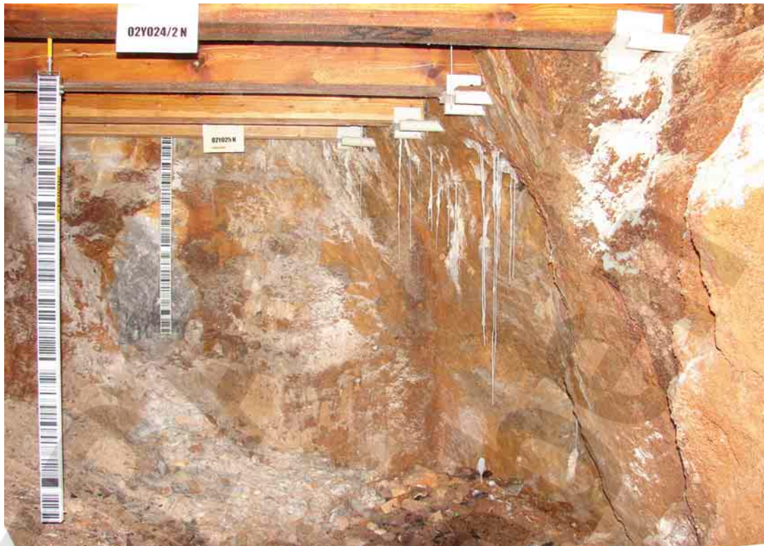
Abbildung 10: Abbausohle, Niveau -204 mNN, Tropfstellen am westlichen Stoß
