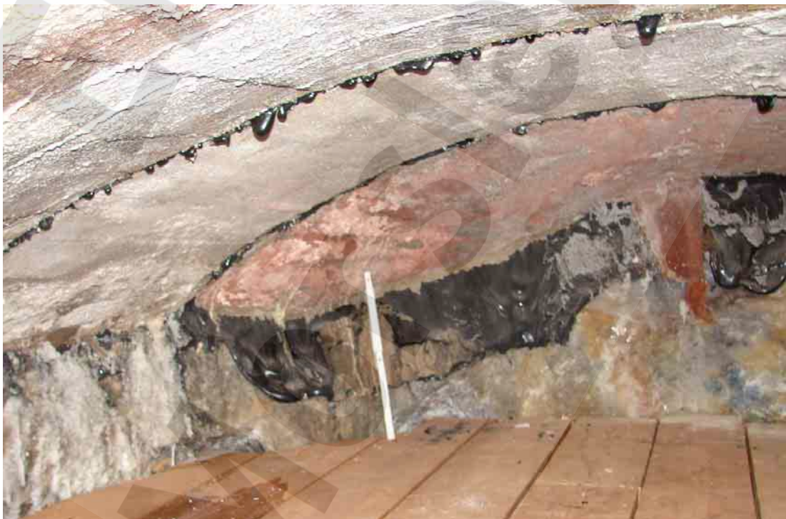
Abbildung 9: Gewölbesegment GS 1 bei -202 mNN, austretender Asphalt
