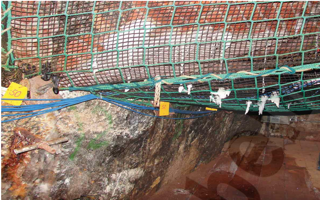
Abbildung 7: Gewölbesegment GS 10, Bühne 3, Feuchtestellen am östlichen Stoß
