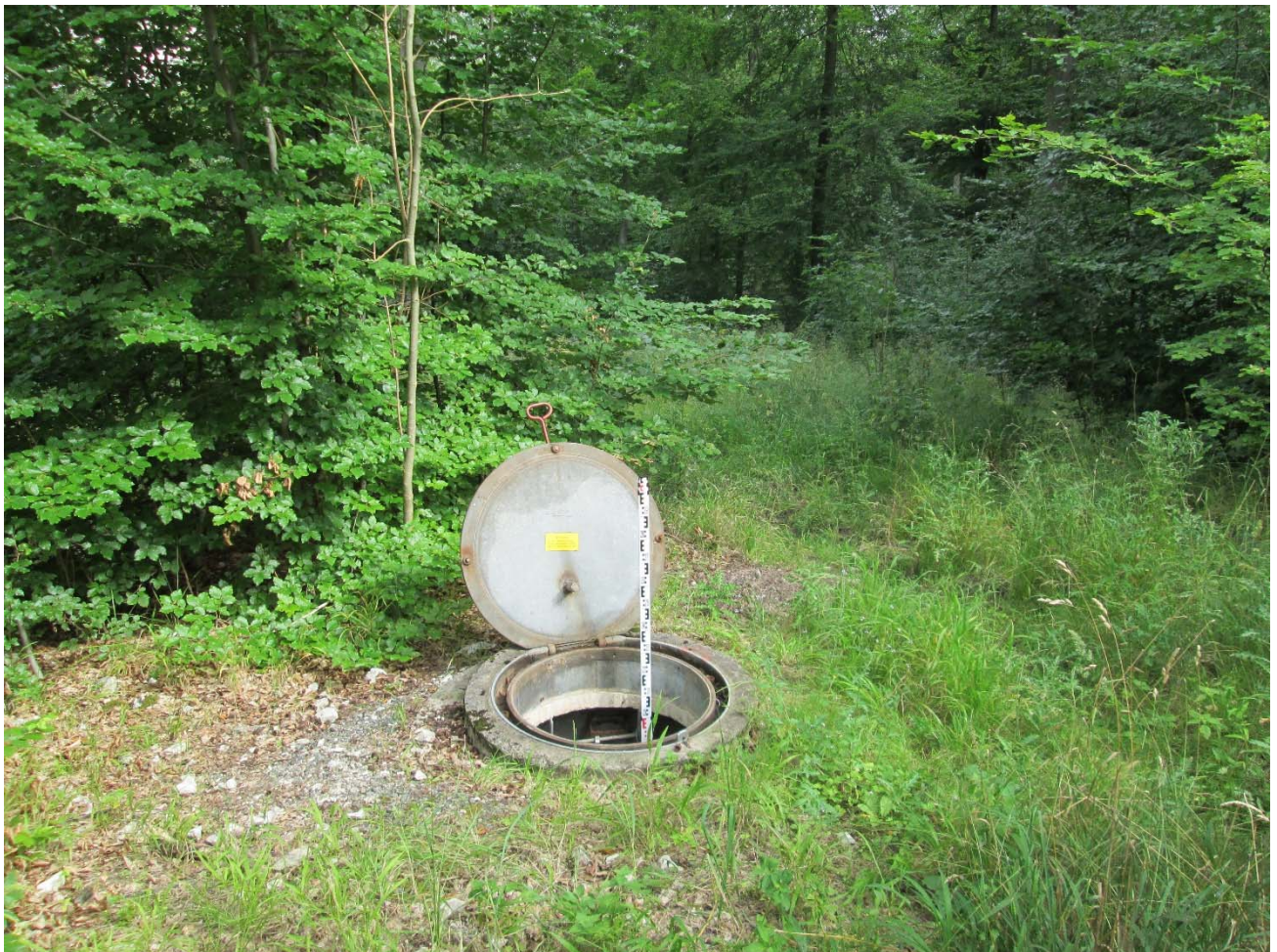
Abbildung 13: Grundwassermessstelle GW-012 (Aufnahmedatum: 20.08.2012)
