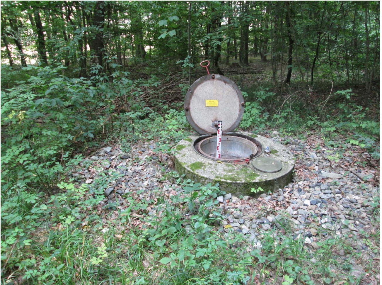
Abbildung 8: Grundwassermessstelle GW-007 (Aufnahmedatum: 21.08.2012)
