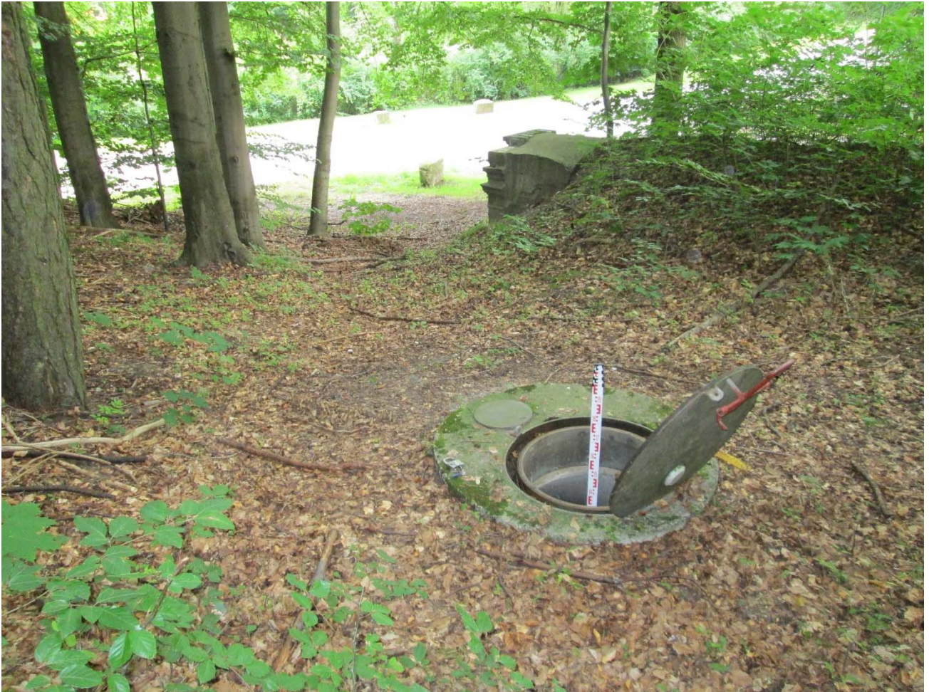
Abbildung 9: Grundwassermessstelle GW-008 (Aufnahmedatum: 21.08.2012)
