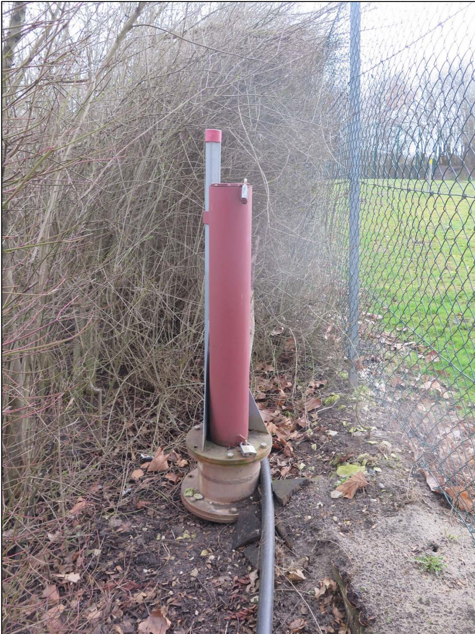
Abbildung 7: Grundwassermessstelle GW-006 (Aufnahmedatum: 10.03.2017)
